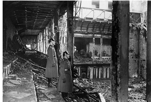
Abb. 10: zerstörter Plenarsaal des Reichstagsgebäudes 1
